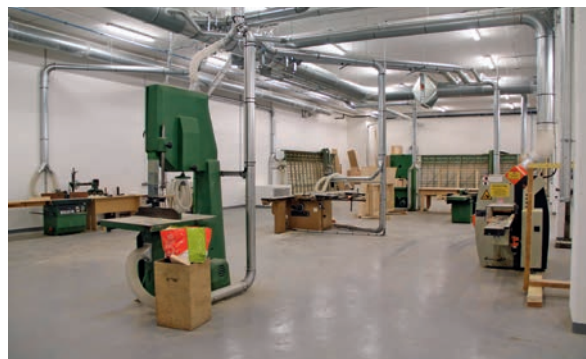
▲ L'atelier de menuiserie et son système de dépoussiérage et de ventilation.
